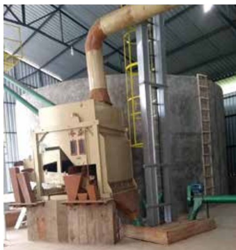
Unidade finalizada com equipamentos de limpeza e movimentação dos grãos
